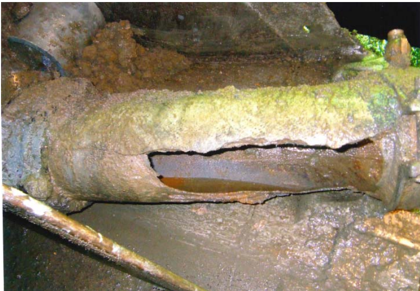
図表 3-20 漏水した管路
